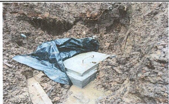
Foto 6: TUBO ENTERRADO DE CORRIENTE DE AGUA PLUVIAL
