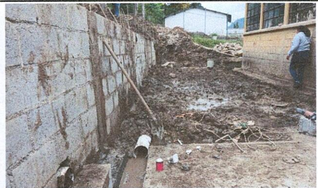
Foto 4: TUBO ENTERRADO DE AGUA PLUVIAL
