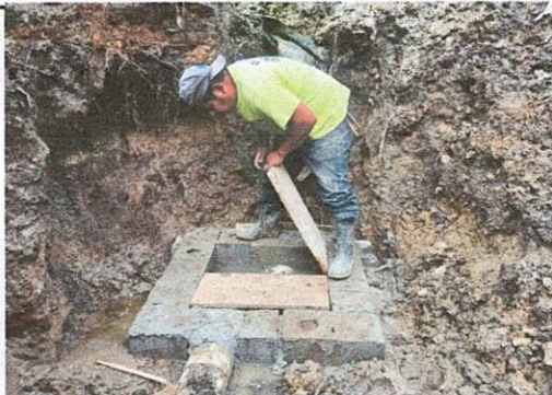
Foto 5: TUBO ENTERRADO DE AGUA PLUVIAL
